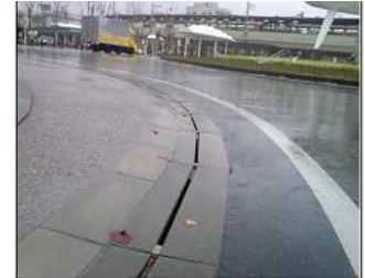
写真-6 連続したスリット集水 集中豪雨時
