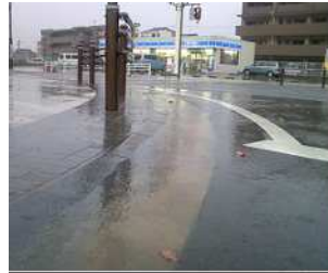
写真-5 従来工法 集中豪雨時
