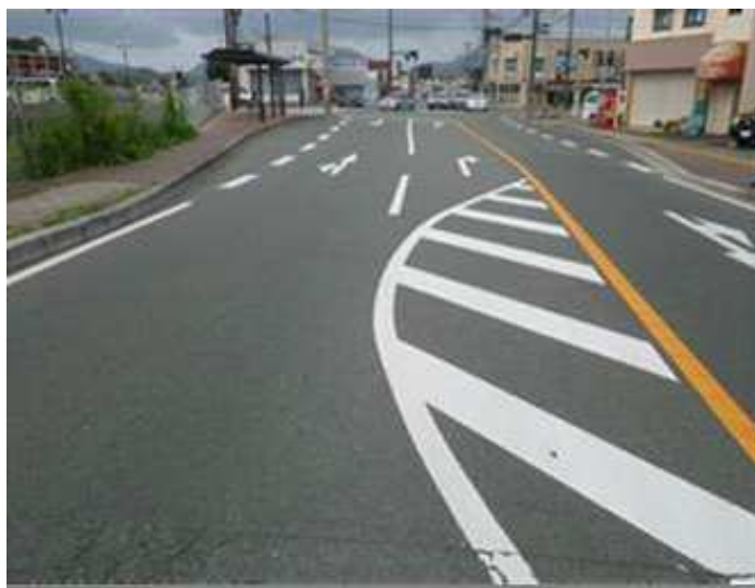
写真-1 スーパーEpoアスコン適用箇所の2年経過後の状況 (福岡県宗像市)
