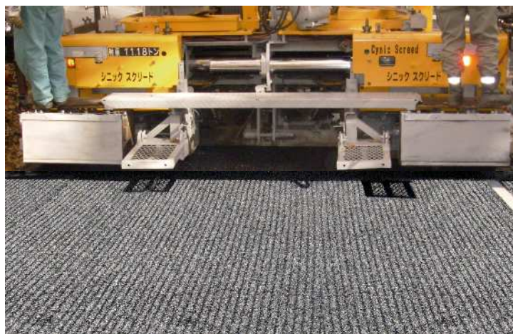
写真-1 専用アスファルトフィニッシャを用いた縦溝粗面形成状況
