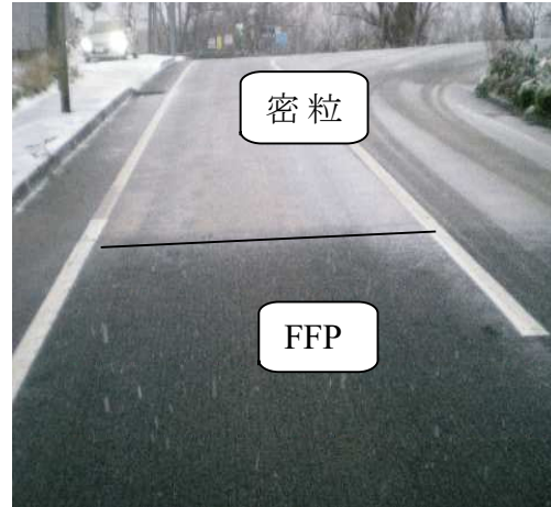
写真-2 凍結抑制剤散布後4時間経過路面状況
