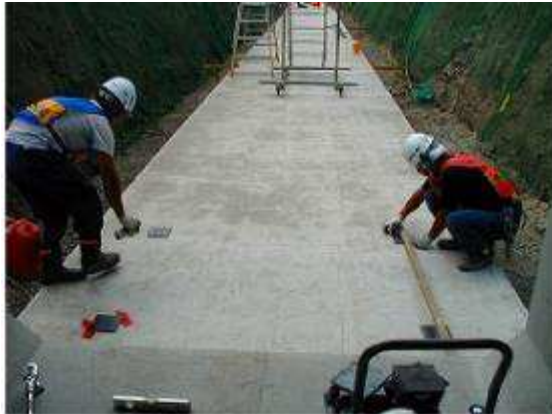
① 基礎コンクリート上での墨出作業及びスライドベース設置作業
