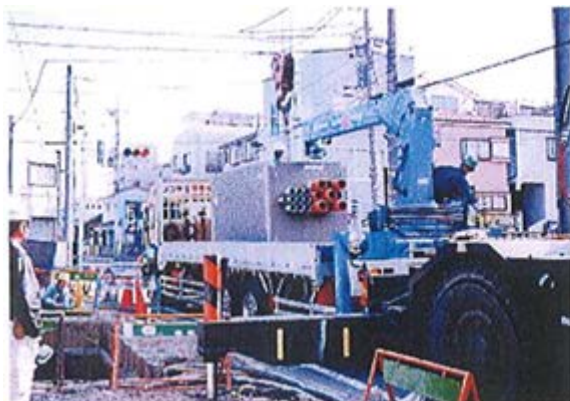
現場納入状況（五面一体にて搬入・設置）
