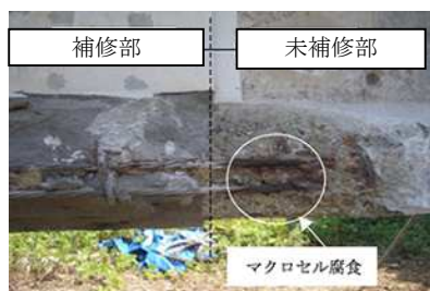
写真-1 マクロセル腐食例
