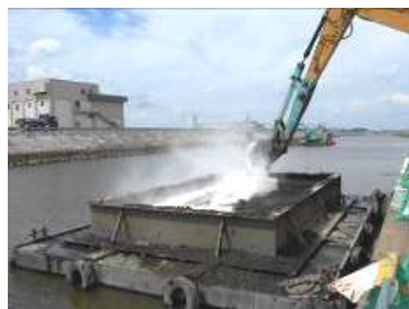
生石灰(大きく飛散する)
