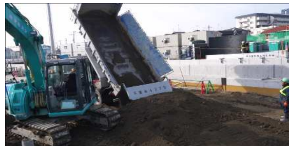
写真-2 関東地方整備局現場納品状況
