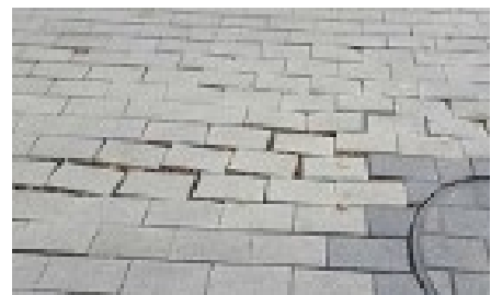
写真-4 従来ブロック施工状態 (不具合発生時)
