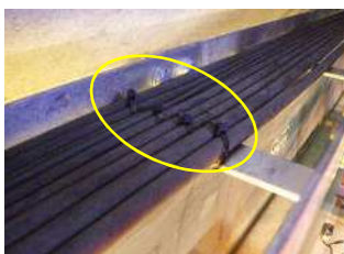
写真-4 トンネル内ケーブルラック
