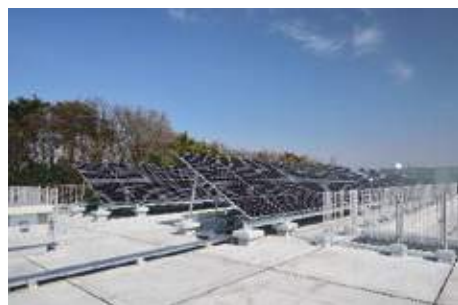
太陽光パネルを設置した例
